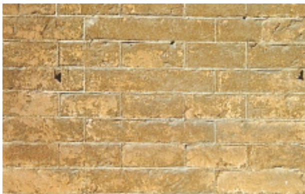
Metselwerk met geschilderd voegwerk. Een kwetsbare detaillering die bijdraagt aan de monumentwaarden
