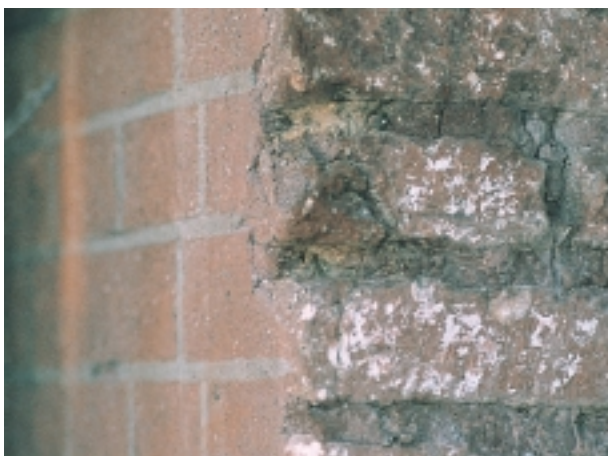
Ouder metselwerk met 19de-eeuwse imitatiebaksteen pleisterwerk; de ondergrond is niet altijd wat hij lijkt te zijn!
